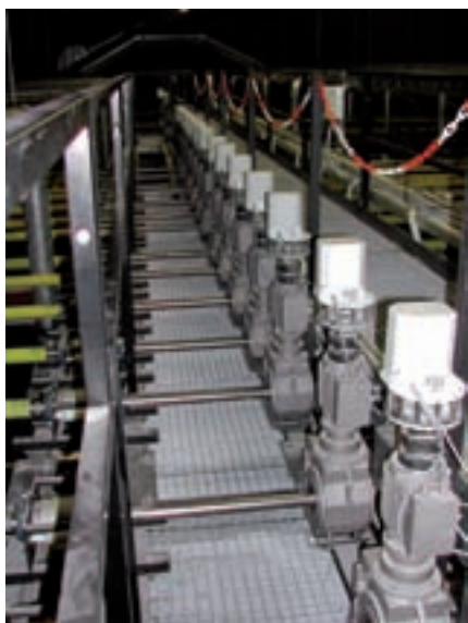
Stolze 19 Goetze-Rohrwellenzüge im Kulturzentrum Mersch, Luxemburg
